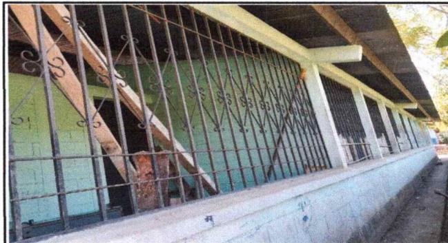
Foto 2: Se observa el área de ventanería balcones oxidada y desprendimiento de pintura de pared módulo 1.
